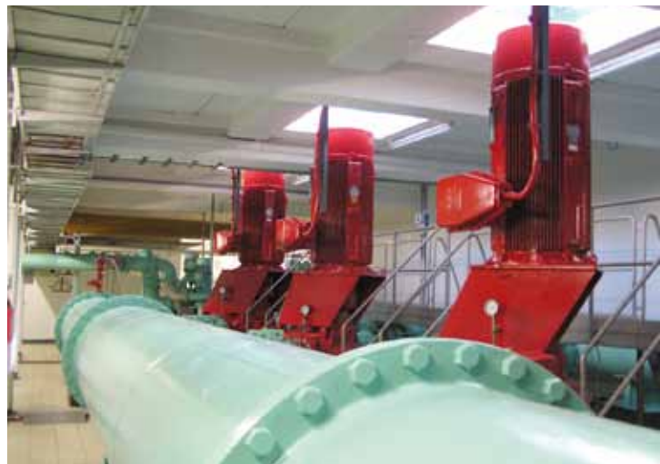
Hauptversorgungsleitung aus dem Wasserwerk Hardtwald mit Netzpumpen
