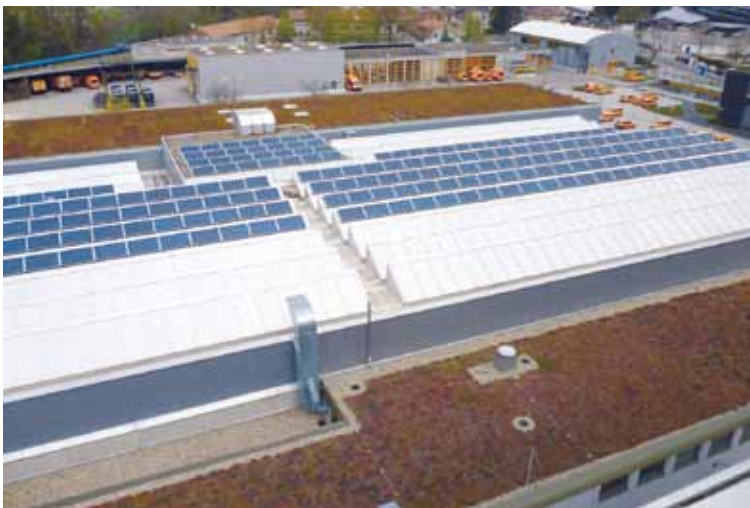
Saniertes Scheddach der Zentralwerkstatt mit Photovoltaik-Anlagen; im Vorder- und Hintergrund die Gründächer des Sozialbaus und des Zentrallagers
